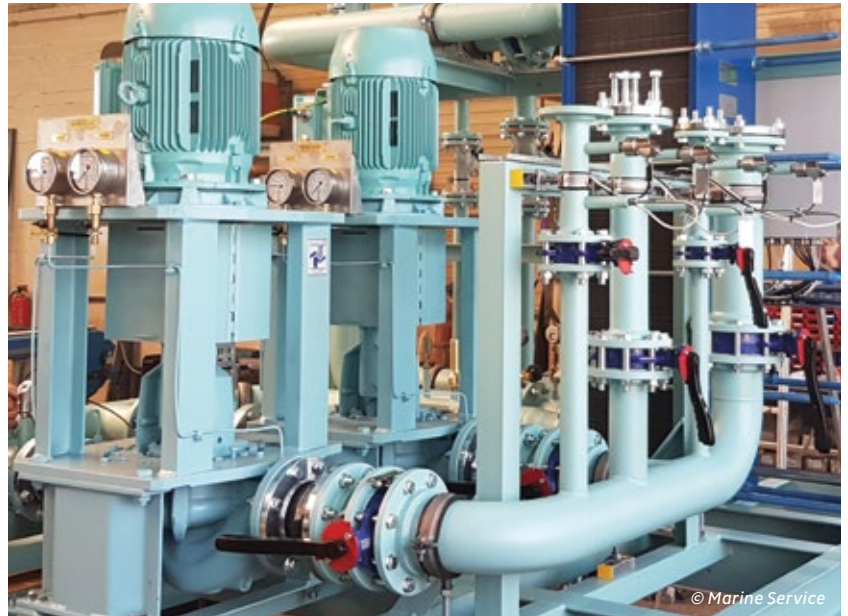
Wärmenutzung: Glykol-Wasser-Module übertragen die Wärme der Schiffsmaschinen zu den LNG-Verdampfern und Nacherwärmern
