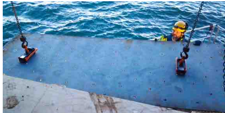
HALT. Zwei TML-250-Lasthebemagneten im Einsatz bei Reparaturarbeiten an der Lauttasaari Brücke in Helsinki.
